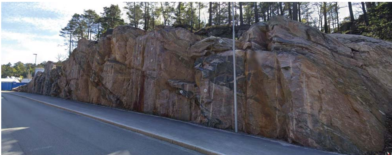
Figur 10 Bergskjæring ved tiltaksområdet. Stort sett massive lite forvitrede bergarter. Unntak med bånd der det kan være forvitring sees til høyre i bildet. Tydelige avrenning av brunrødt materiale kan observeres flere steder (sprekk midt i bildet og like til høyre for stolpe)
