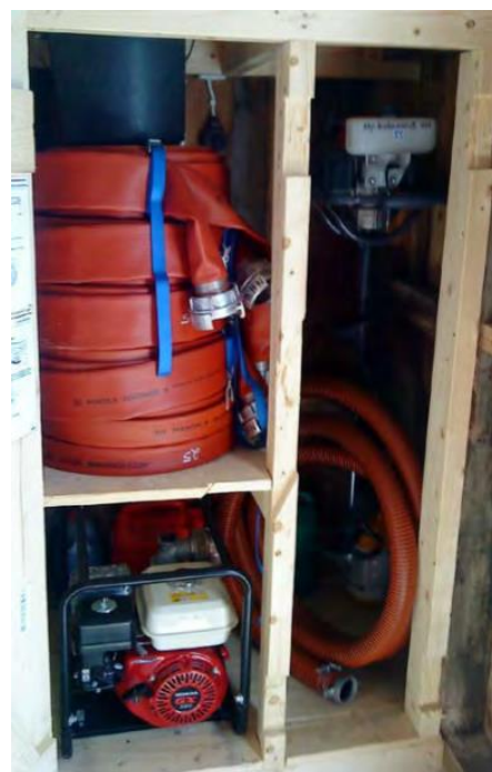
Fotografiet viser innholdet i skapet med brannvernutstyr som står i postbua på Vilhelm Krags brygge (kommunebrygga). Foruten bensindrevet brannpumpe inneholder skapet seks brannslanger à 25 meter samt ledning for opptak av vann fra sjø. I dette skapet finnes også et bensindrevet isbor.
